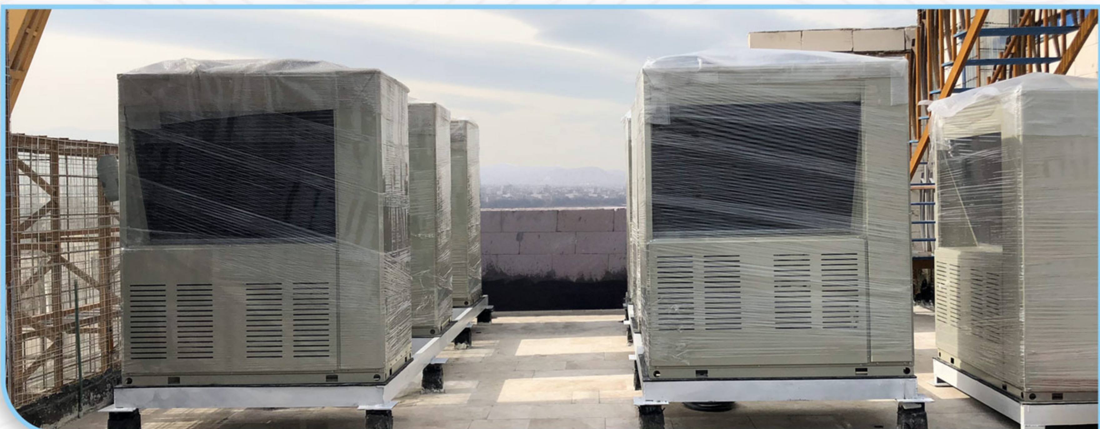
مجتمع مسکونی، مشهد بلوار ابوذر غفاری، فروش، نصب و راه اندازی هفت دستگاه مینی چیلر ۱۰ تن تبرید
